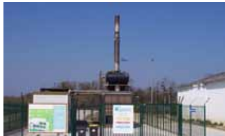
Photo 3 - Plate-forme de valorisation du biogaz
