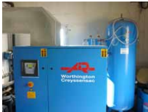
Photo 5 - Compresseur pneumatique pour le pompage des lixiviats avec le nouveau système d'extraction d'air
