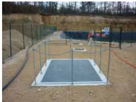
Photo 7 – Bac décanteur sous caillebotis en amont du « bassin AK1 »
